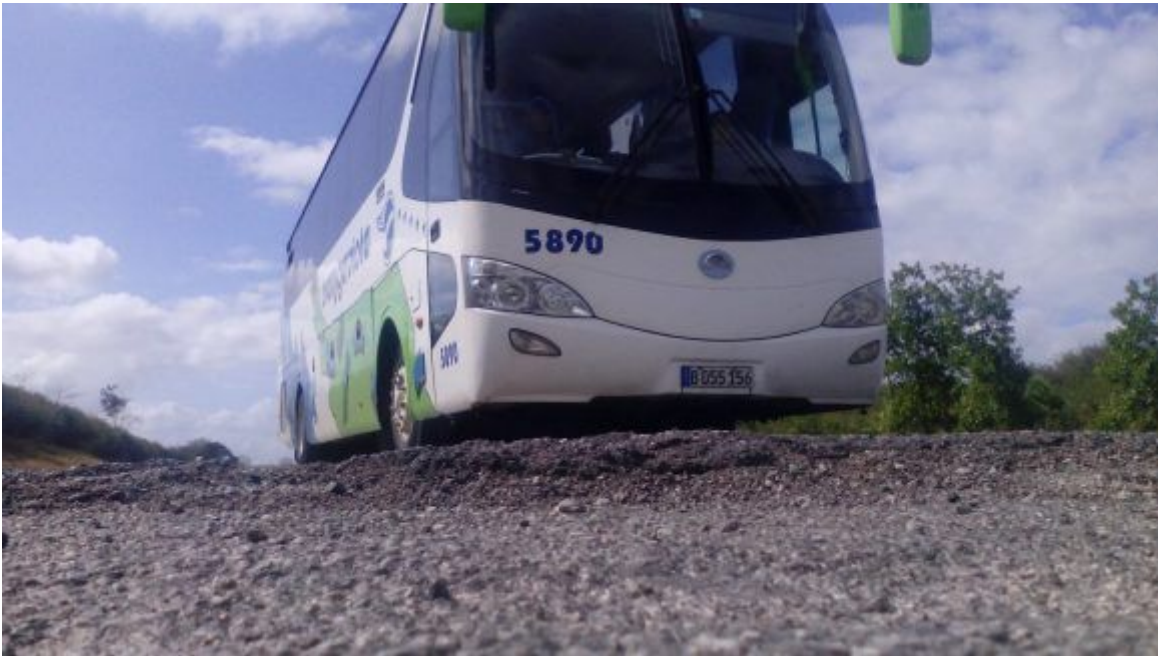
Los vehículos sufren los desniveles y baches de la principal vía del occidente y centro del país.
