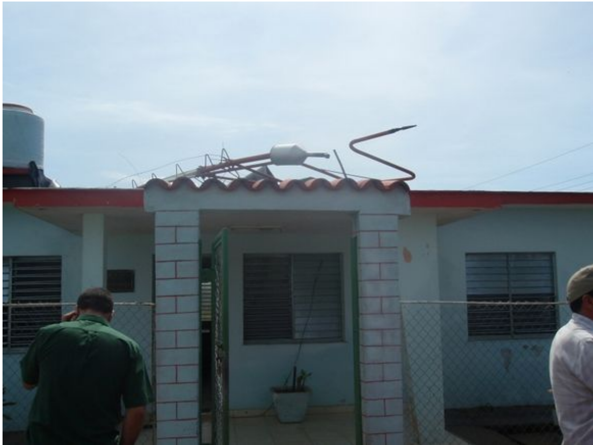
El mástil y el sensor de medición del anemómetro Dines tumbado en el techo de la estación meteorológica de Paso Real de San Diego, después de ser derribado por la racha máxima de 340 km/h. Foto: José Rubiera.
