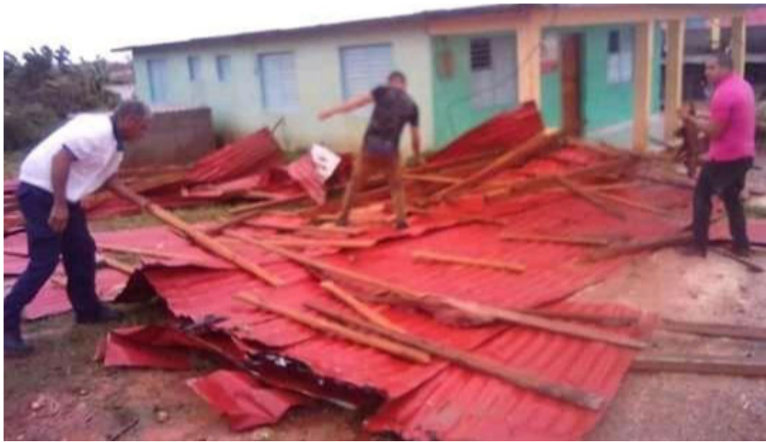
Daños preliminares de la tormenta Laura en el oriente de Cuba. Foto: ACN
