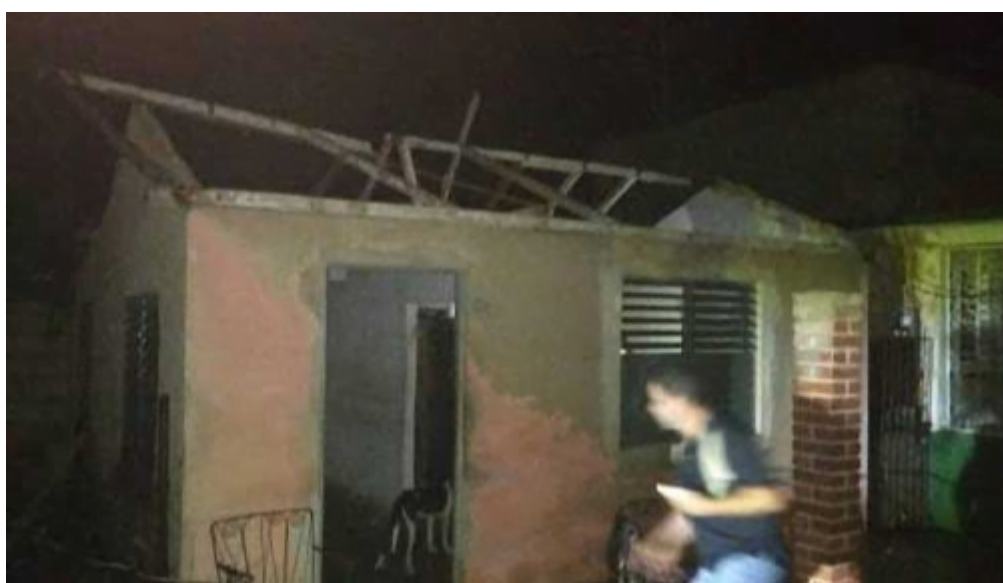
Afectaciones en cubiertas de viviendas provocó un tornado en el municipio de San Cristóbal, provincia de Artemisa. Foto: Juventud Rebelde.
