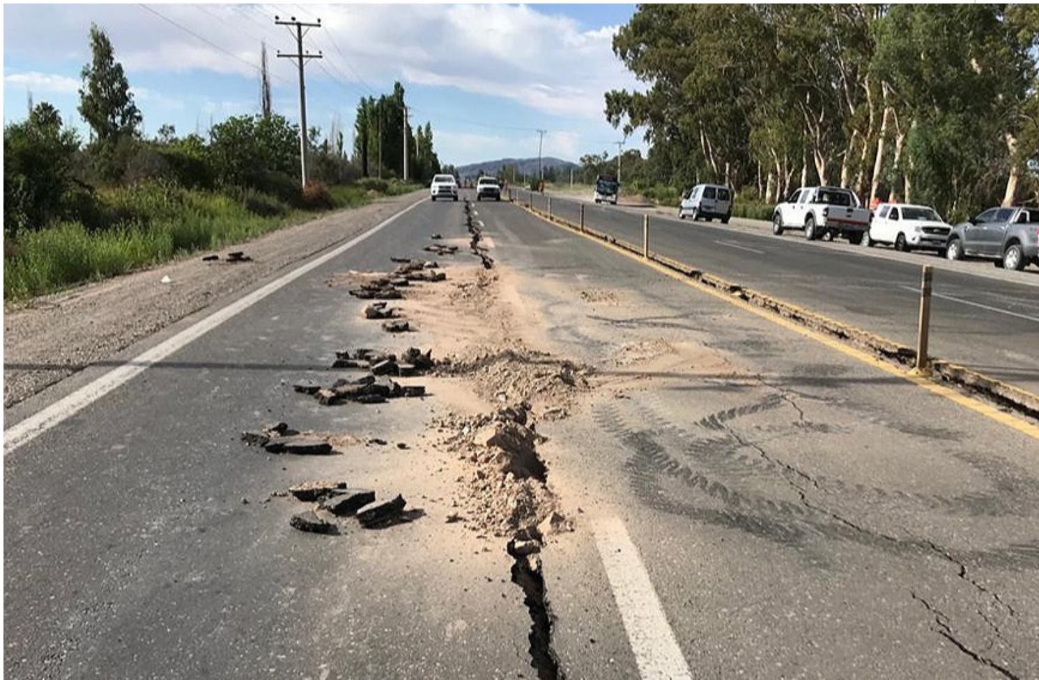
Daños causados por el sismo en la provincia de San Juan, Argentina. Foto: Telam
