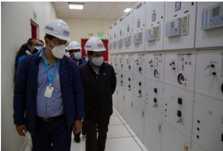
Arce recorre planta de energía solar
