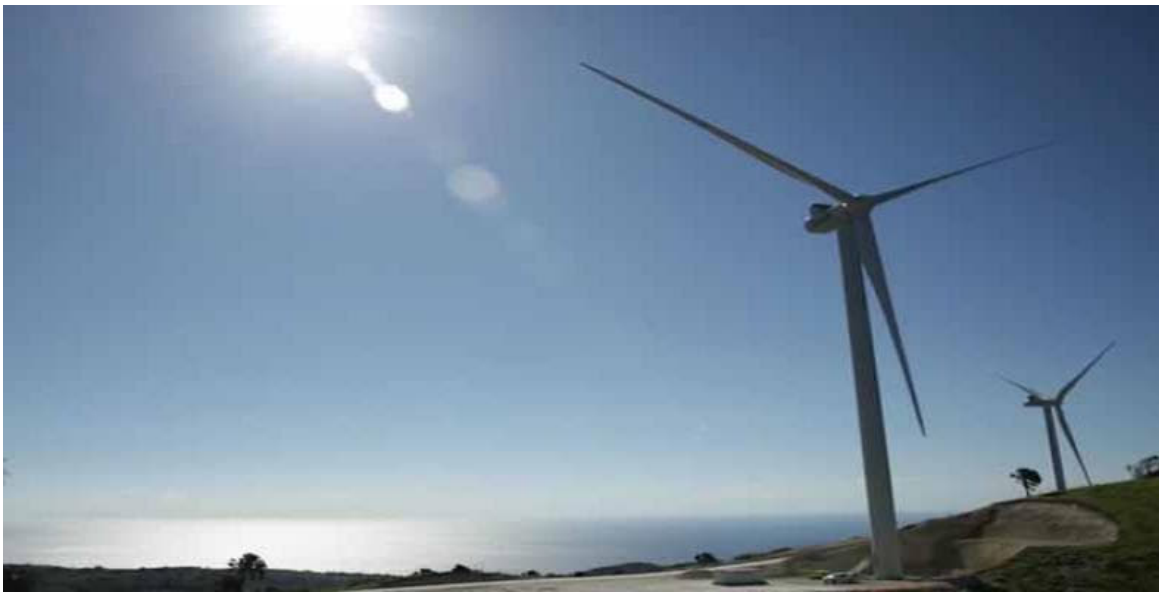
Parque Eólico de Gibara, una de las principales fuentes de energía renovable de la oriental provincia de Holguín. Foto: Archivo/RHC.
