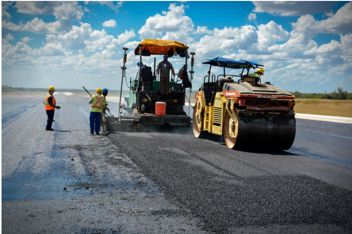
En fase final repavimentación de la pista del aeropuerto de Holguín. Foto: Juan Pablo Carreras Vidal/ACN.
