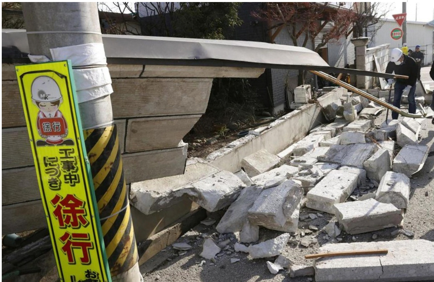
Destrosos ocasionados por el sismo en Japón. Fuente: Telam
