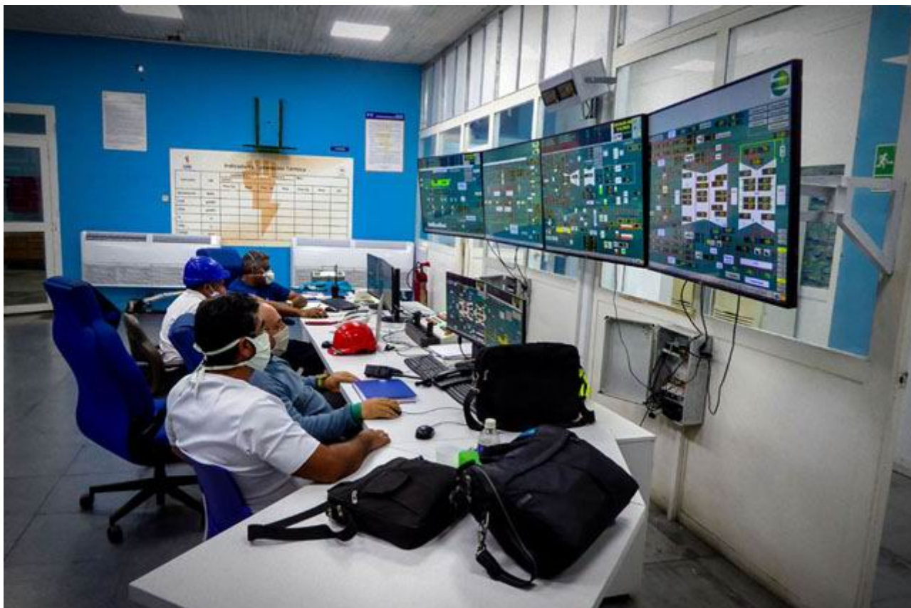
Termoeléctrica de Felton aporta generación estable tras avería. Foto: Radio Rebelde.
