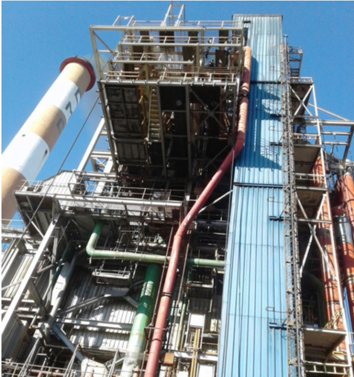
El bloque después del enfriamiento está en la etapa de lavado de la caldera. Foto / Mireya Ojeda
