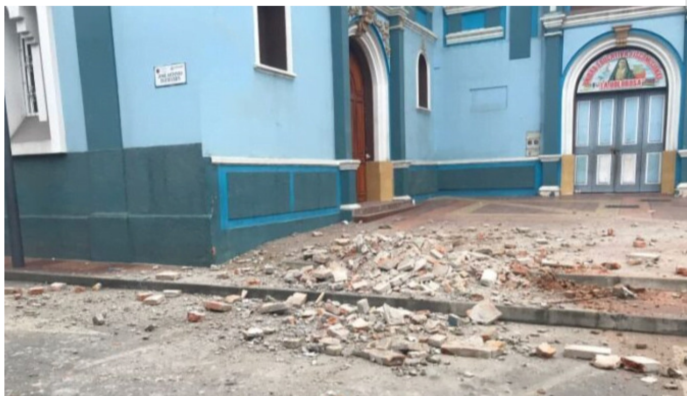
Daños en Ecuador por sismo en Perú
