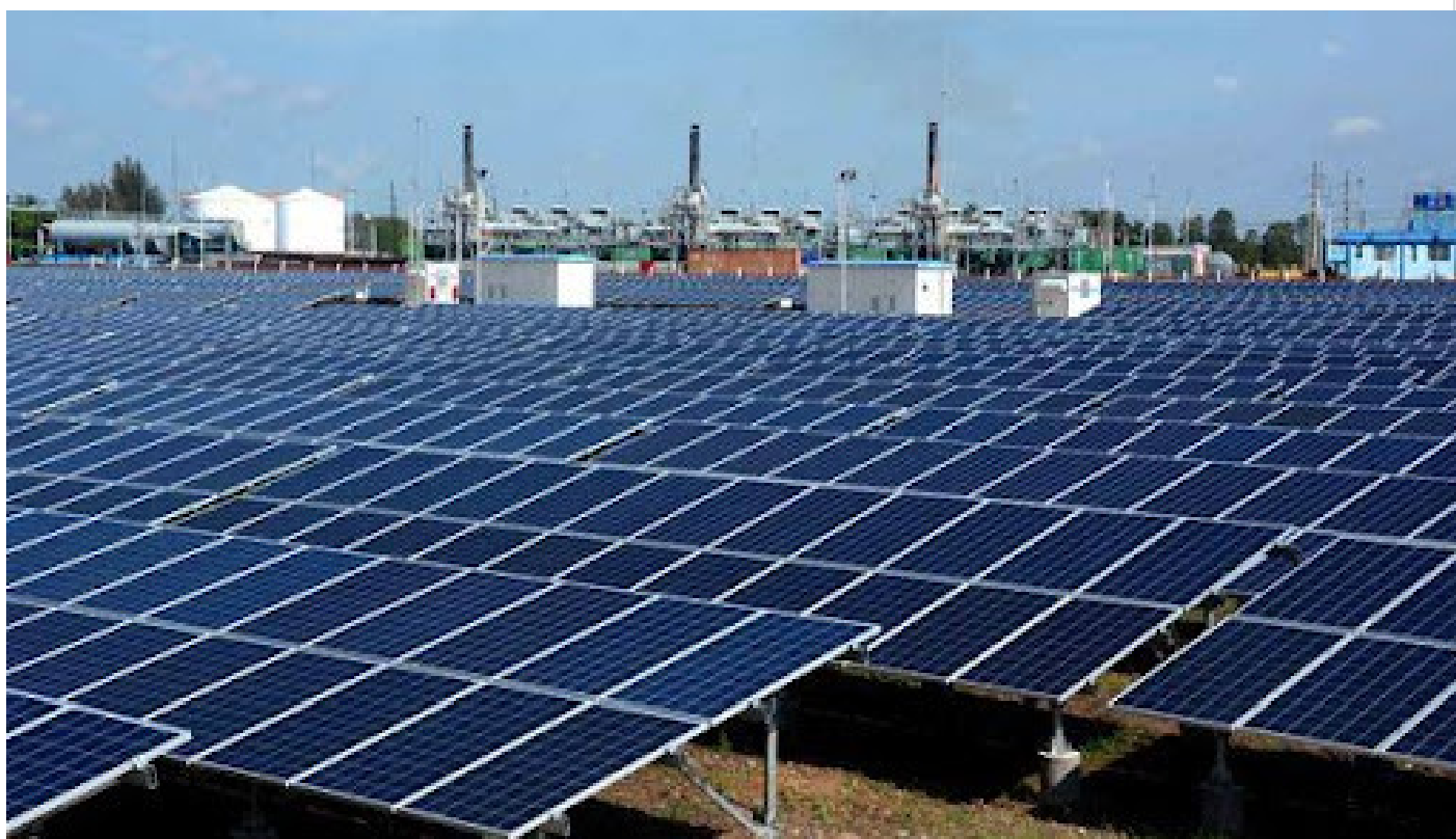
Instalación de energía fotovoltaica en Cuba
