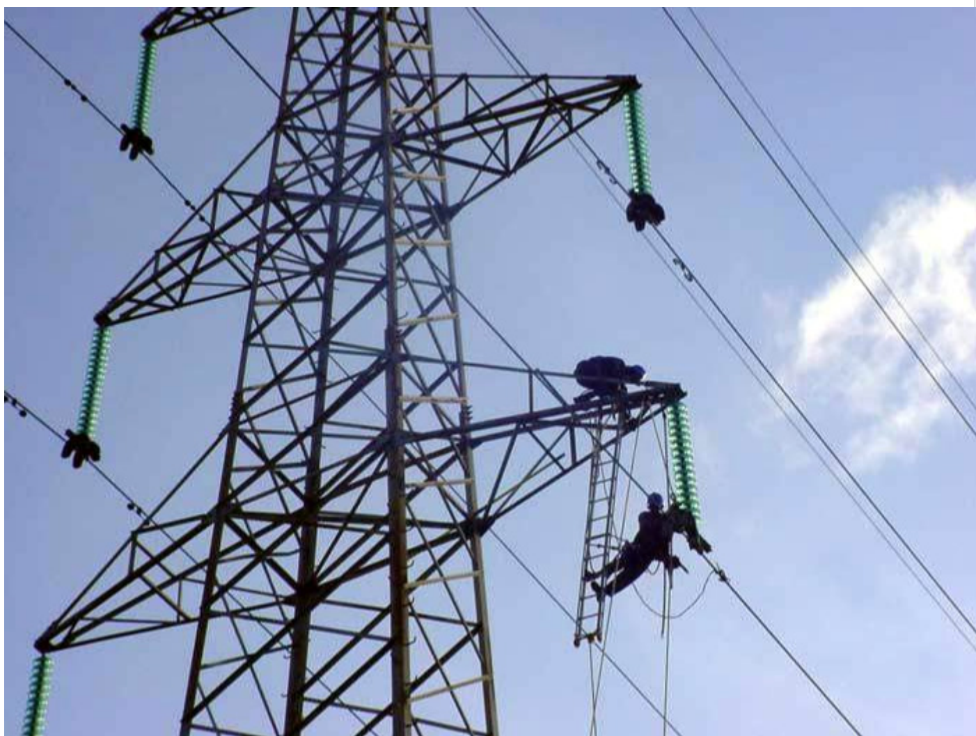
Torres para líneas eléctricas de alta tensión
