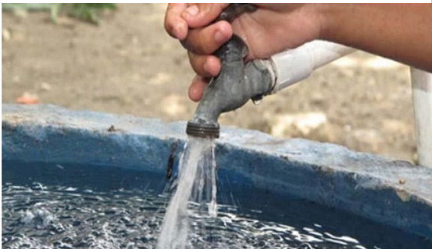
Servicio de agua en Pinar del Río
