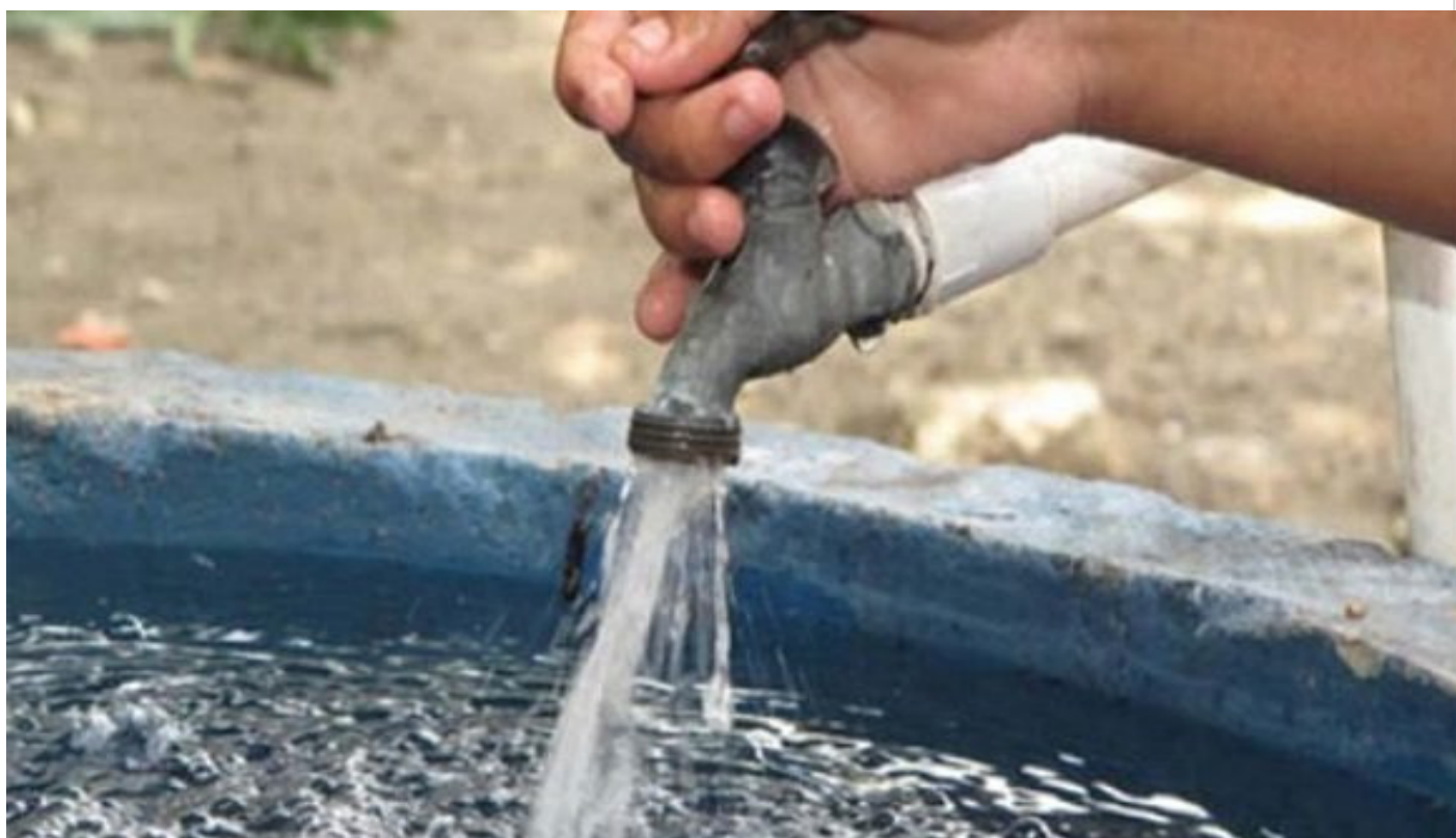
Servicio de agua en Pinar del Río
