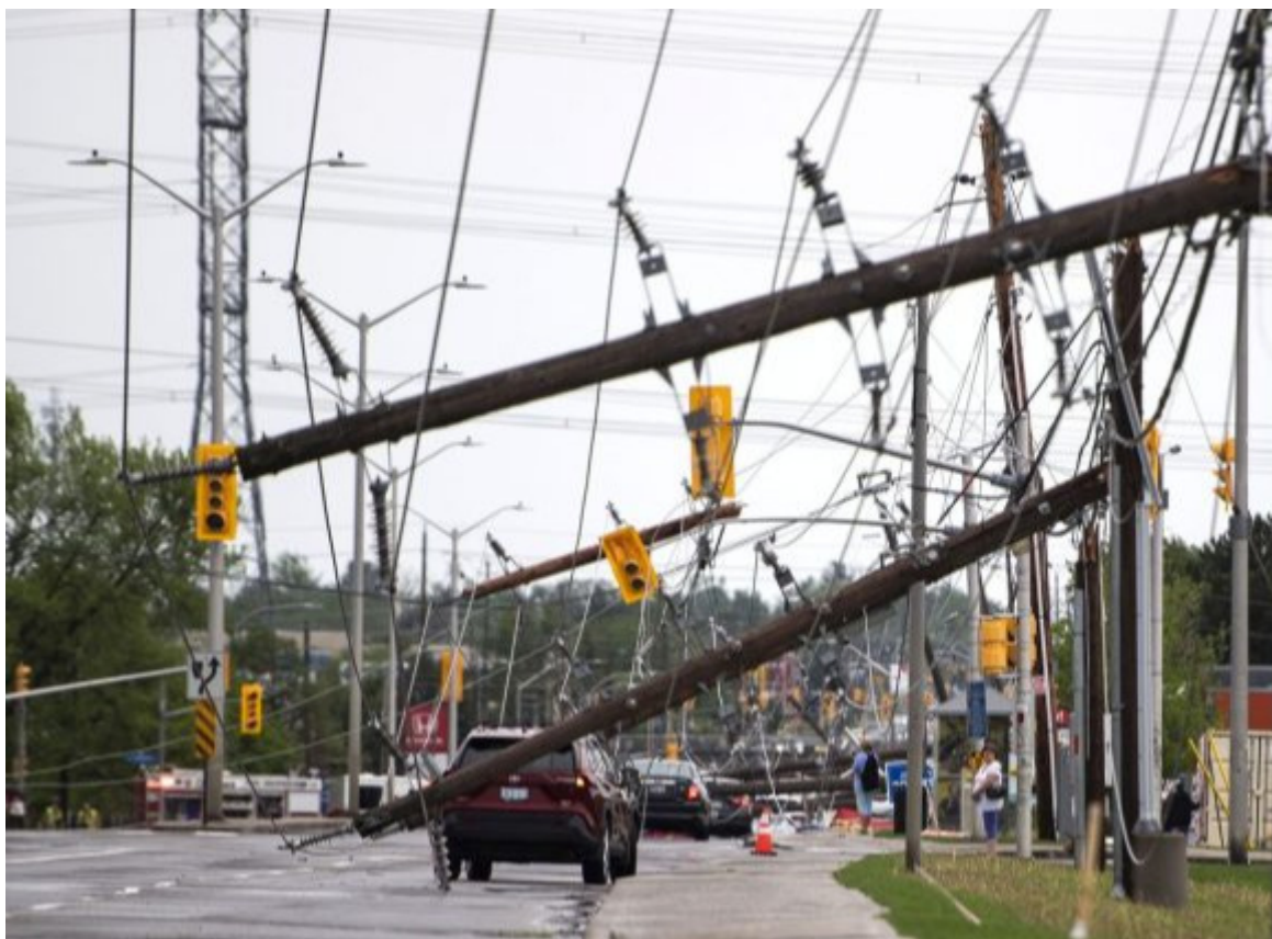
La tormenta derribó postes de luz, árboles y causó daños en viviendas y automóviles. Foto Ap
