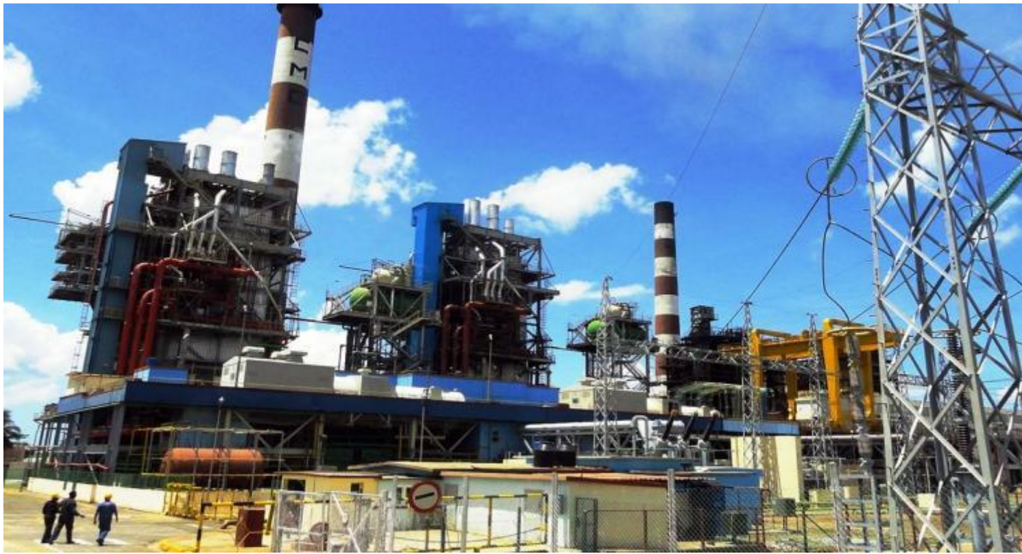
Sur la photo, la centrale électrique de Cienfuegos.
