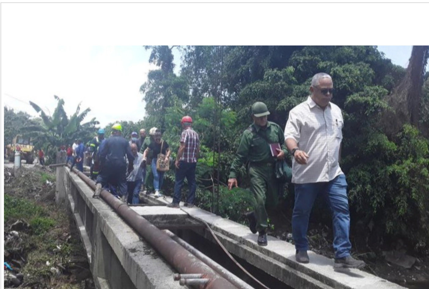
Chequean Luis Antonio Torres Iríbar y Reinaldo García Zapata labores de saneamiento y extracción de restos del puente de La Polar que colapsó el pasado viernes tras las intensas lluvias en La Habana
