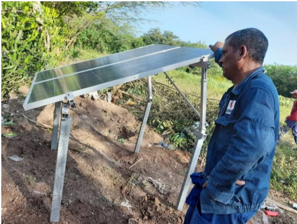
Estos sistemas están compuestos por dos paneles solares fotovoltaicos de 300 watts. Foto: Cortesía Empresa Eléctrica de Granma
