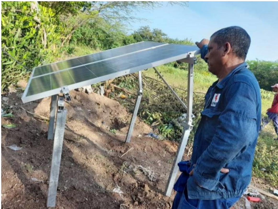
Estos sistemas están compuestos por dos paneles solares fotovoltaicos de 300 watts. Foto: Cortesía Empresa Eléctrica de Granma
