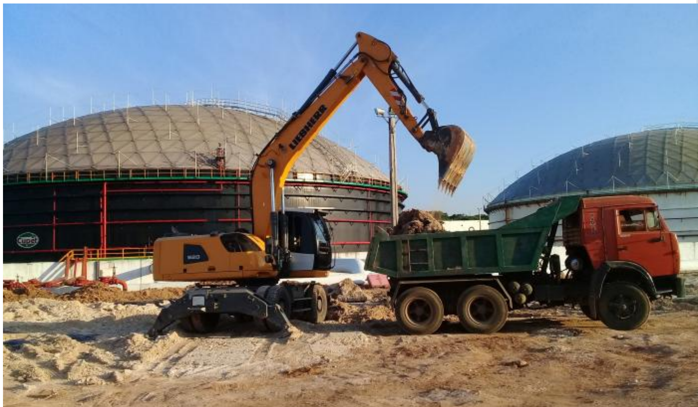
Fuerzas de diversos organismos trabajan intensamente en labores de limpieza y escombros en la Base de Supertanqueros. Foto: Ventura de Jesús García
