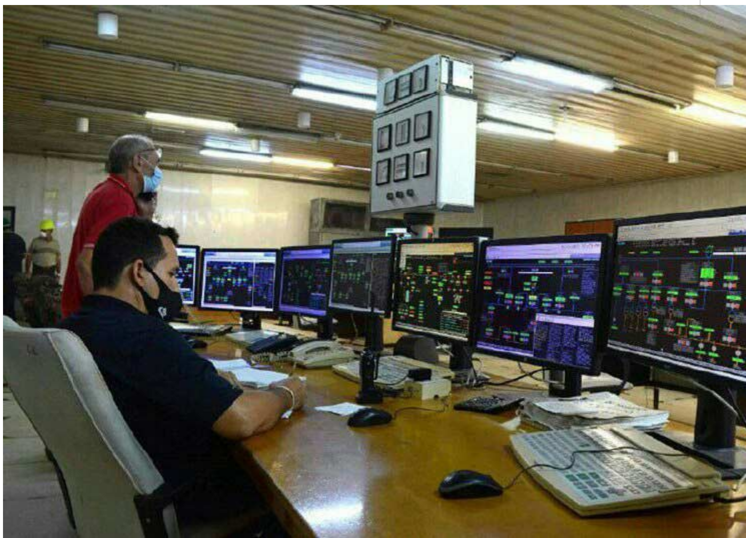
Laboran por recuperar generación en Termoeléctrica de Nuevitas. Foto: ACN
