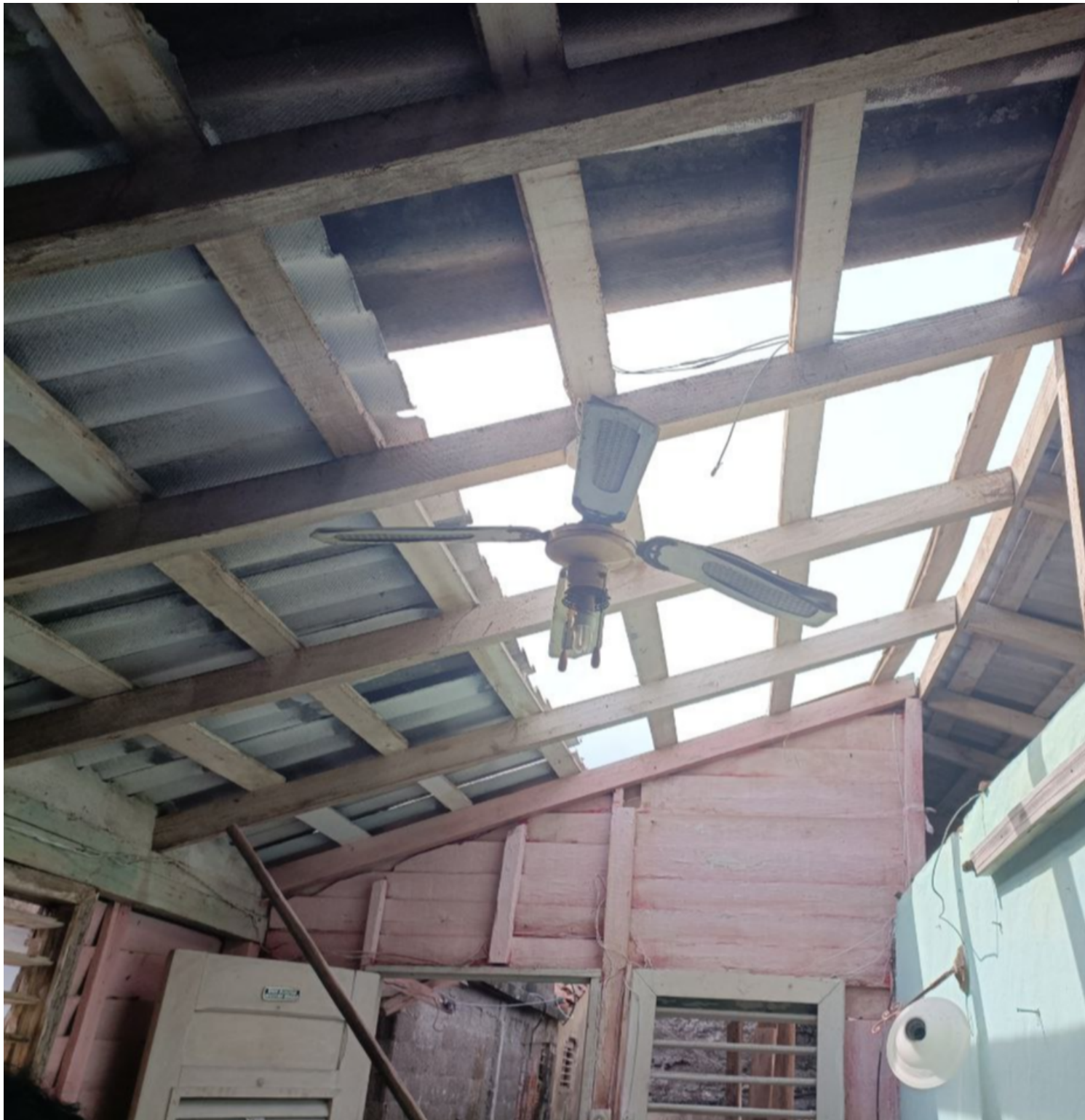
Les logements ont été fortement touchés par Ian . Photo : Cubadebate
