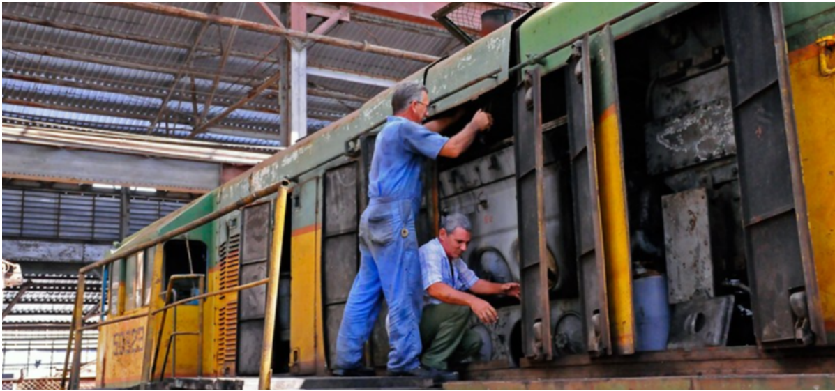
Taller de reparación de locomotoras en Morón, Ciego de Ávila. Foto: Archivo/Alejandro García Sánchez
