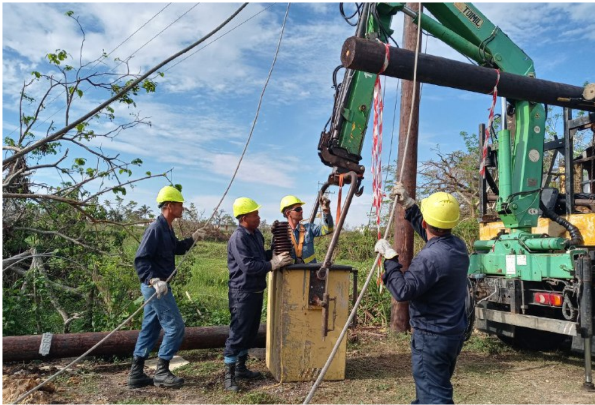
Brigadas de la Unión Eléctrica refuerzan apoyo a Vueltaabajo. Foto: Evelyn Corbillón
