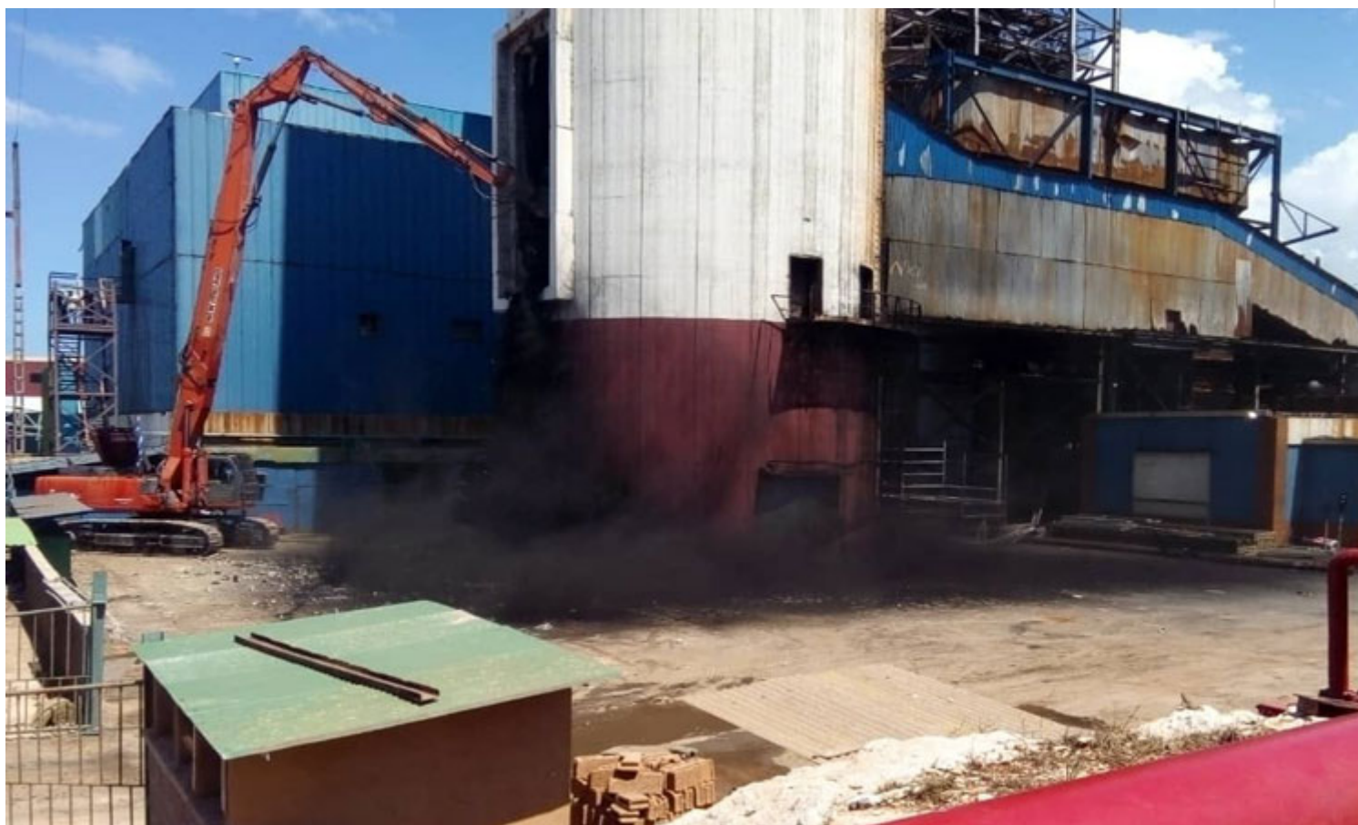
Abierto orificio en chimenea
