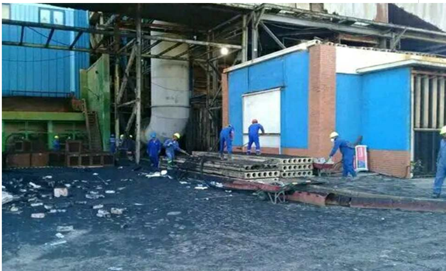
Recuperación termoeléctrica Guiteras
