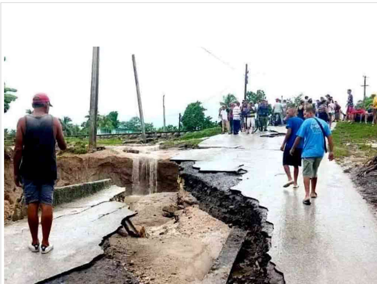
Los viales también han sido muy dañados por las precipitaciones. Foto tomada de Prensa Latina
