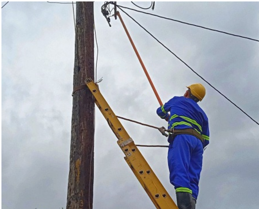
Se trabajó con celeridad para resarcir los daños en los cuatro circuitos primarios. Foto: Ana Esther Zulueta
