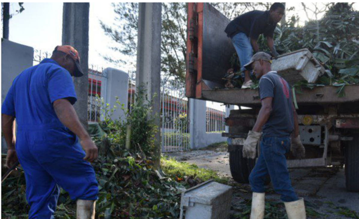
La recogida de desechos y árboles caídos en las calles continúa en los barrios de Boyeros. Foto: Omara García Mederos
