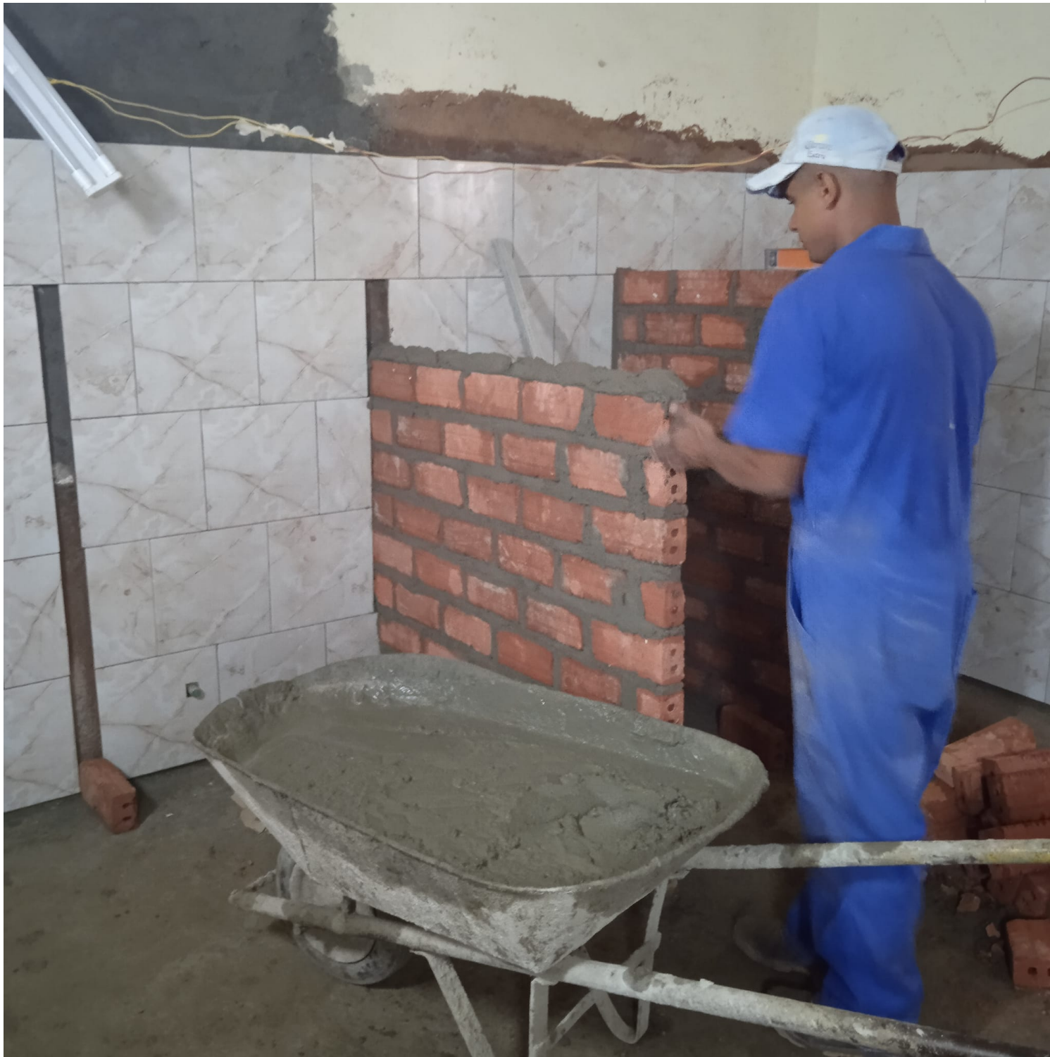
Acciones constructivas en importantes instituciones sanitarias de Sancti Spíritus. (Foto: Arelys García)
