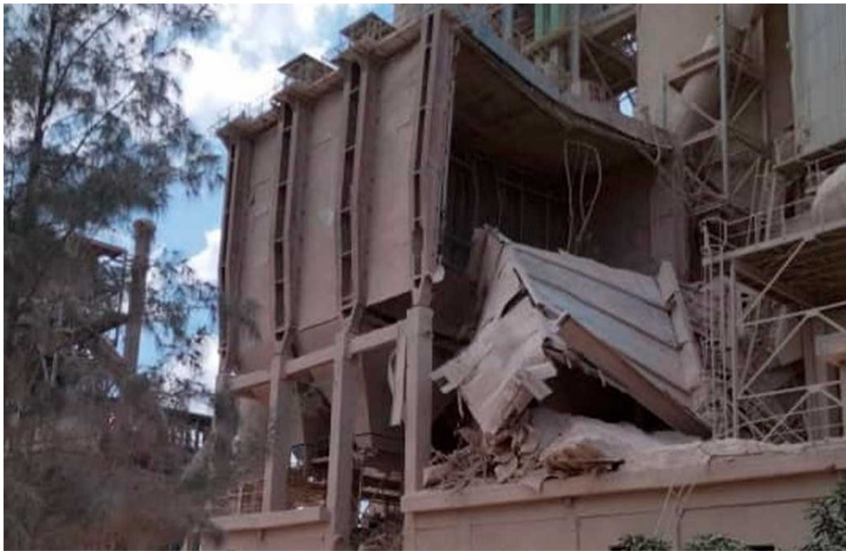
El accidente ocurrió por un derrame de material en una de las tolvas de la industria. Foto tomada de Prensa Latina
