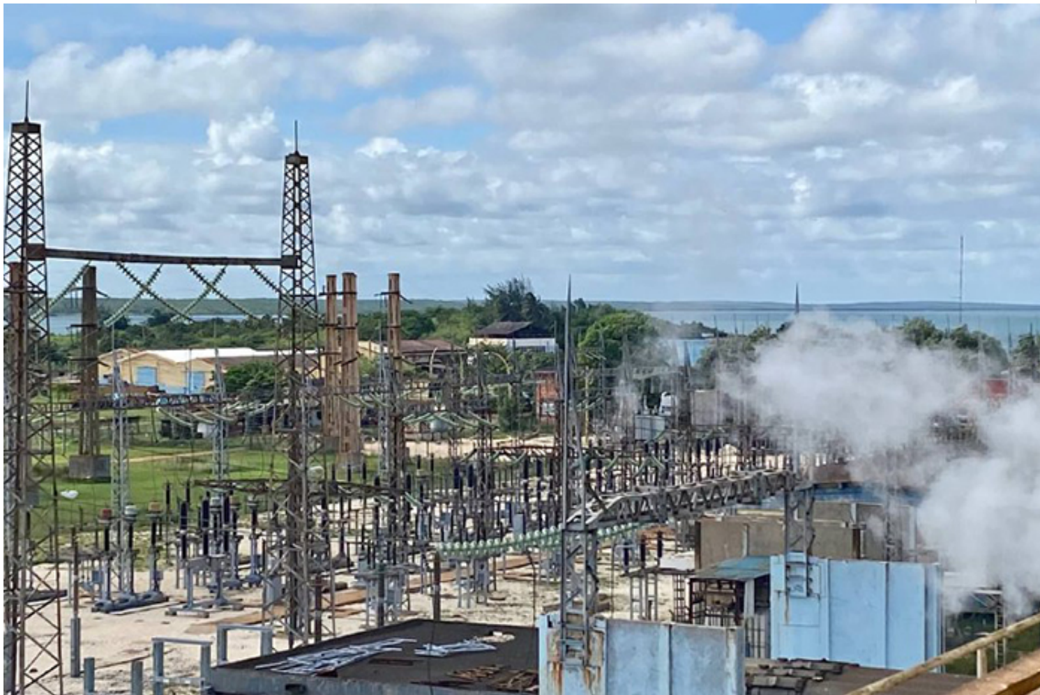
Central Termoeléctrica 10 de Octubre. (Foto: Rodolfo Blanco Cué/ACN)
