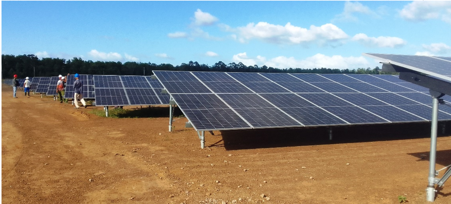
Parque Solar Fotovoltaico Alcalde Mayor.
