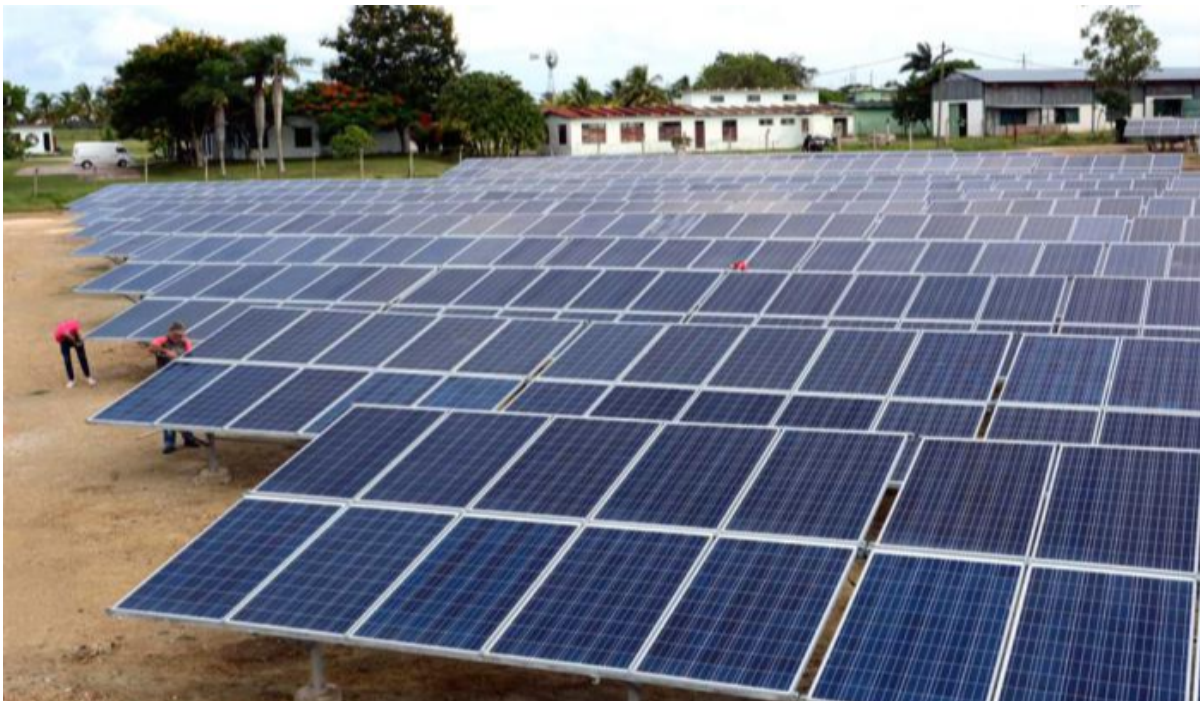
Parque fotovoltaico en Camagüey. Foto: periódico Granma
