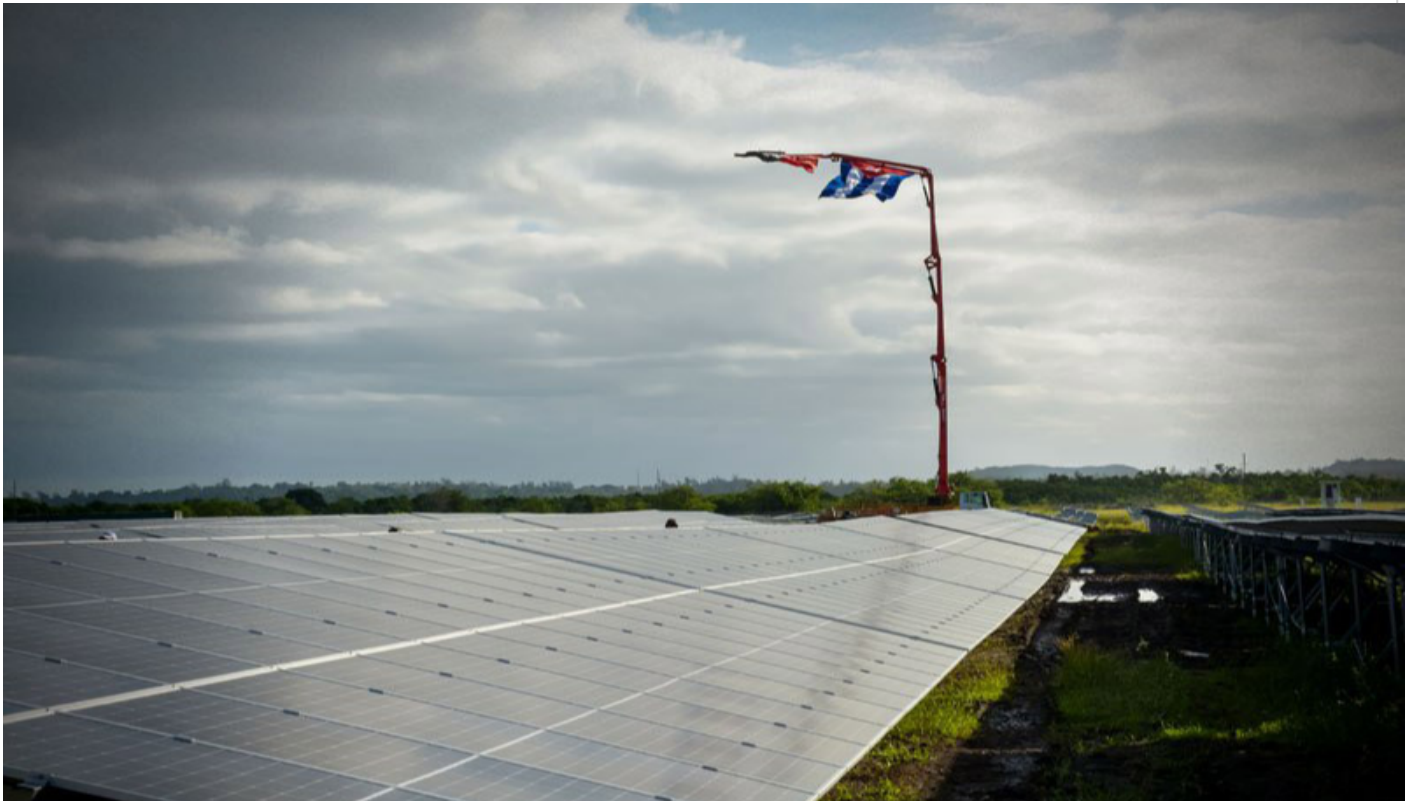
Parque fotovoltaico Corúa 5. Foto: Juan Pablo Carreras
